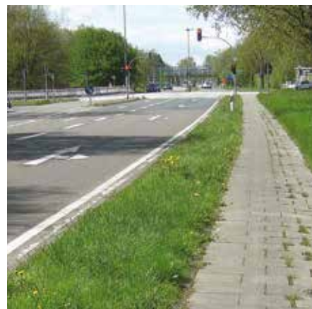
Unebener Radweg an der Poristraße
